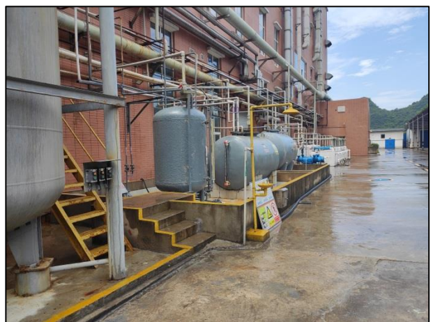
API-III 原料药车间北面酸碱罐、母液中转罐
