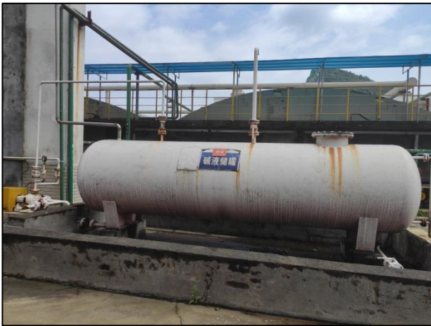
锅炉房北面碱罐
