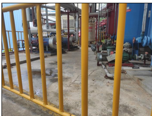
青霉素原料车间西北面母液中转罐
