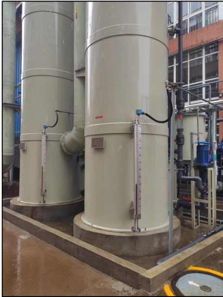
API-I 原料药车间北面废气处理塔
