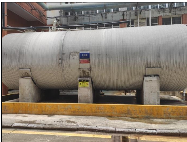
API-II 原料药车间北面高浓废水中转罐
