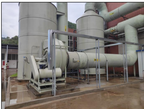
API-III 原料药车间西面碱液喷淋塔
