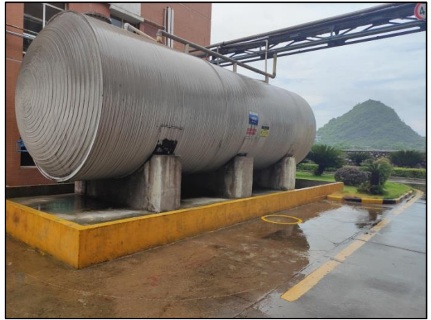
API-I 原料药车间北面高浓废水中转罐
